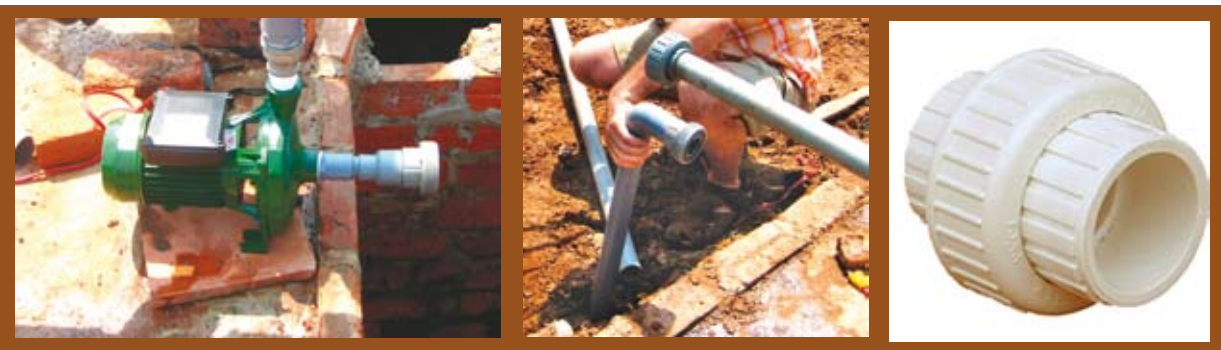
Bích nối máy bơm với nguồn nước và hệ thống tưới
